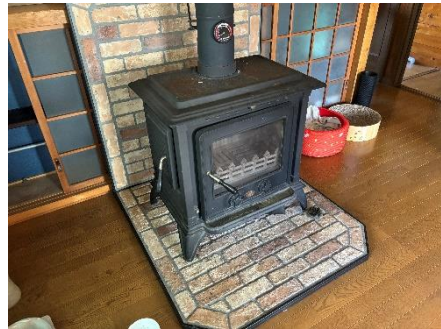
1階 薪ストーブ（廊下）
