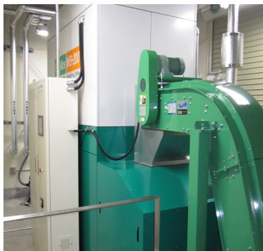
木質資源利用ボイラー (道の駅きらら289)
