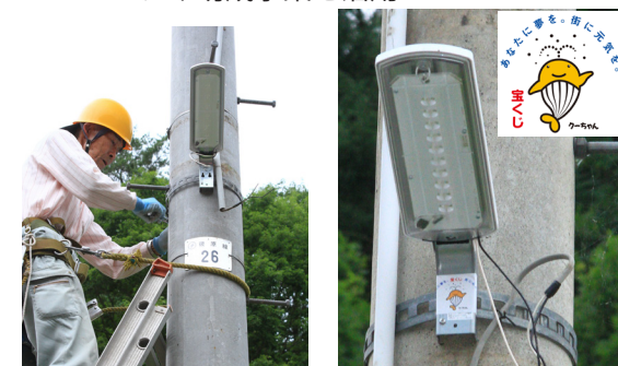
改修された防犯灯
