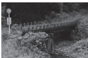
現在通行止めの町道橋（滝原）
