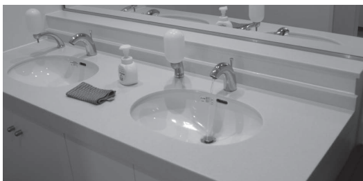
役場トイレに設置されている自動水栓
