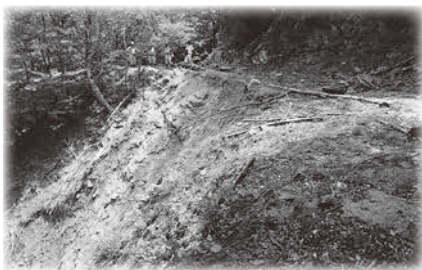
町道鱒沢線の被災状況
