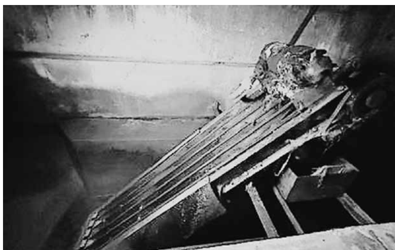
老朽化したたかつえスキー場の 大型污水处理施設(現在停止中)
