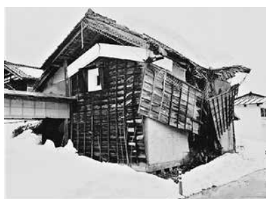
雪害で壊れた土蔵
