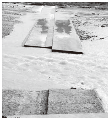
台風19号の影響で被災した大橋堰
