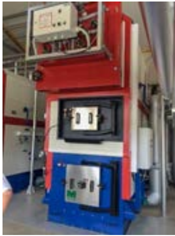
木質チップボイラー (会津高原リゾート)
