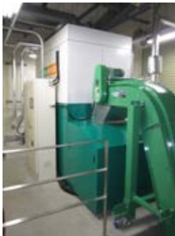
木質チップボイラー (道の駅きらら 289)
