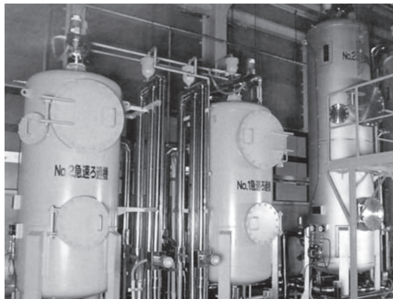
急速ろ過浄水施設（田島地域系沢浄水場）
