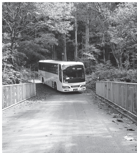
幅員が狭く通行が困難な橋
