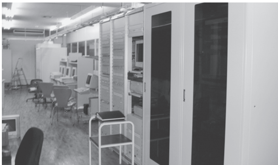
館岩地域広域ネットのサーバー室
