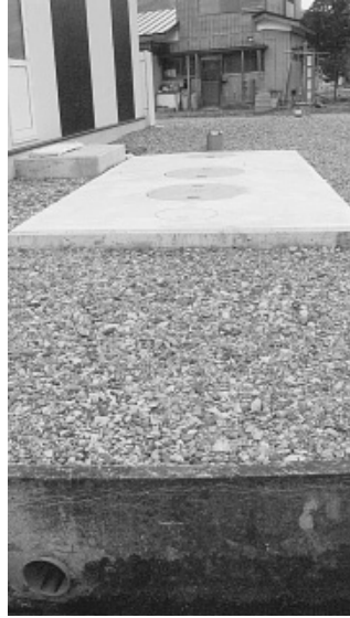
生活雑排水を処理する合併浄化槽
