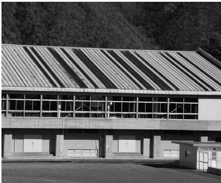
屋根がさびている田島中学校の体育館
