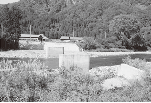
町道大新田1号線南郷橋（令和元年9月27日撮影） 下部工が完了し、橋の製作が始まる
