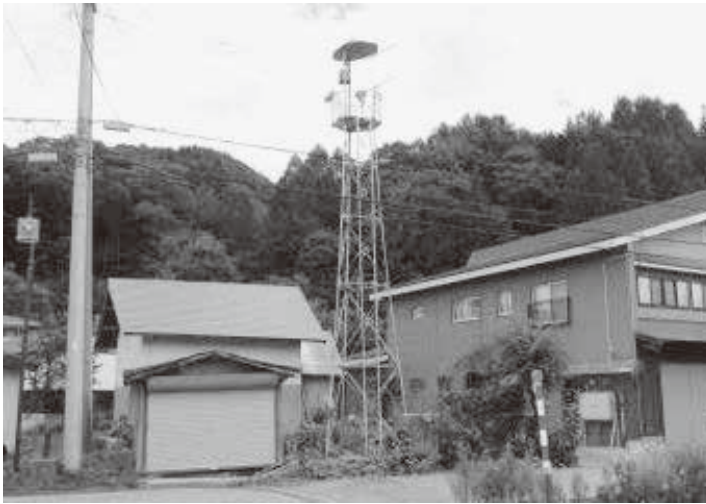
火の見櫓（写真は湯ノ花区内） 経年劣化による倒壊の危険性があることから撤去を行う。
