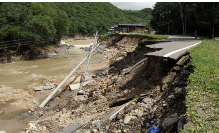
平成27年9月の関東・東北豪雨で被災した国道352号 (館岩地域新田原地内)
