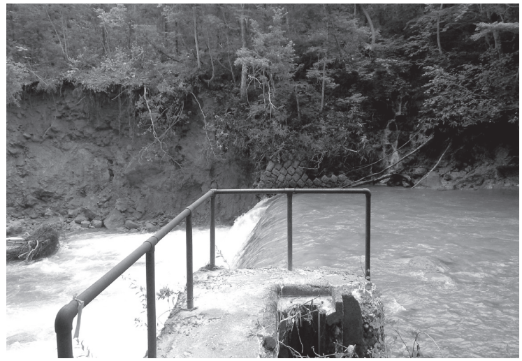
台風18号通過後の旧針生発電所取水口の様子
