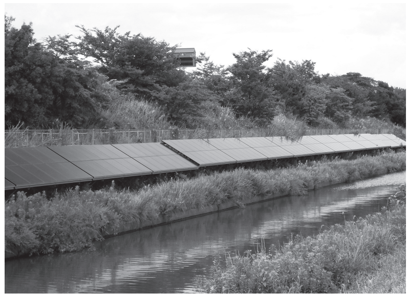
畦畔を利用した小松堀排水路発電施設の太陽光パネル (新潟市亀田郷土地改良区内)
