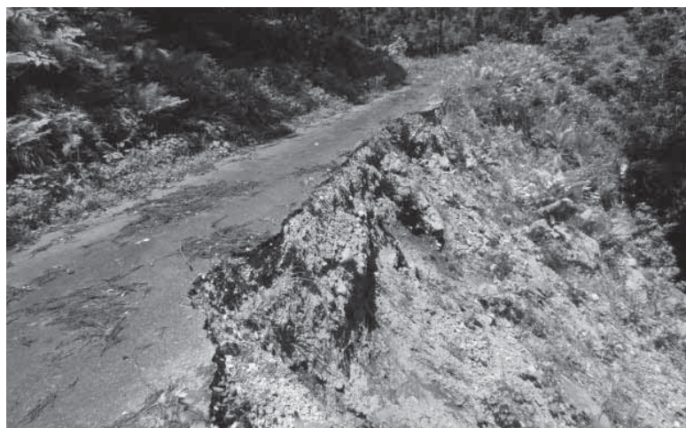
被災した林道横向線の現状
