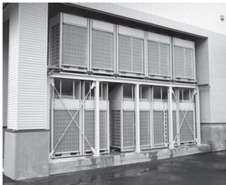
ヒートポンプシステムによる給湯・空調設備
